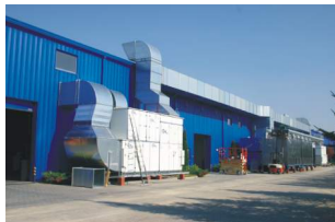
Systemy wentylacji i oczyszczania powietrza
